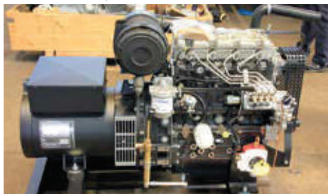
Eine Motorenlieferung und ein Genset kurz vor dem Einbau
